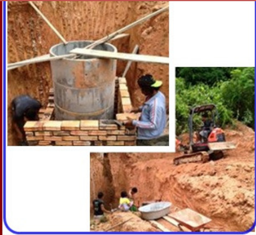
๑๕. ปรับปรุง/ซ่อมแซมอาคาร ศพด. งบประมาณ ๓๙๑,๖๖๗.๘๙ บาท
